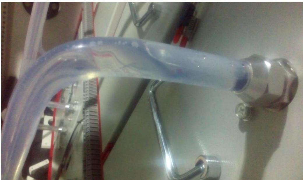
图 8.5 手动排气点 Figure 8.5 Manual exhaust point
